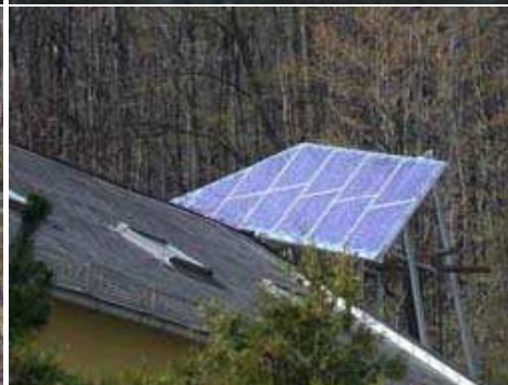
2kW am Dach aufgeständert (keine Dachfläche nach Süd)
